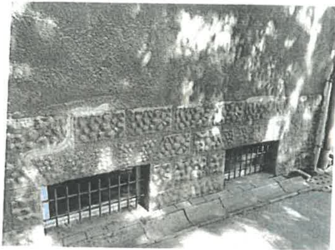
Fot.3 Pęknięcia ścian piwnic przy nadprożach
