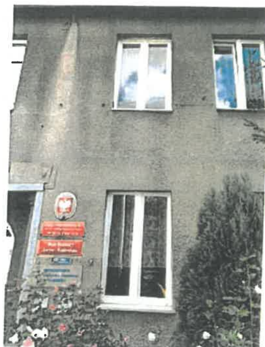
Fot.15 – Okna zewnętrzne – widoczny brak równoległości ramy okiennej i węgaraka
