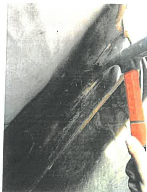
Fot. 8 – Skorodowane, spróchniałe
