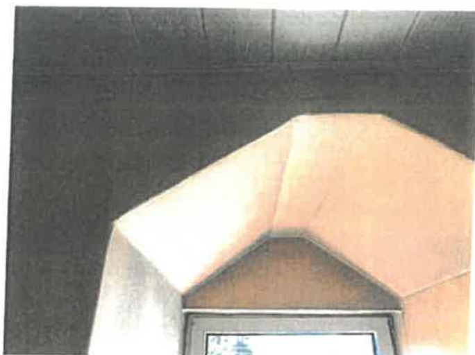
Fot. 6 – Widoczne pęknięcia ścian
