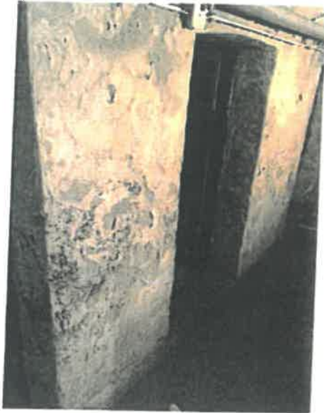
Fot. 1 – zawilgocone ściany piwnic ściany
