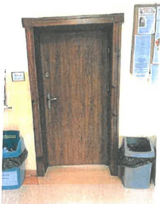
Fot.14 – Drzwi wewnętrzne – szczelina pod drzwiami od 1-5 cm.
