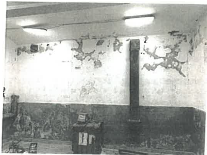
Fot.4 Zawilgocone ściany piwnic
