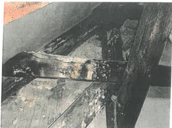
Fot. 9 – Skorodowane elementy więźby dachowej
