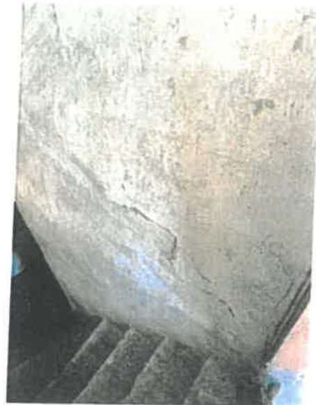
Fot.2 – schody ceglane i zawilgocone ściany
